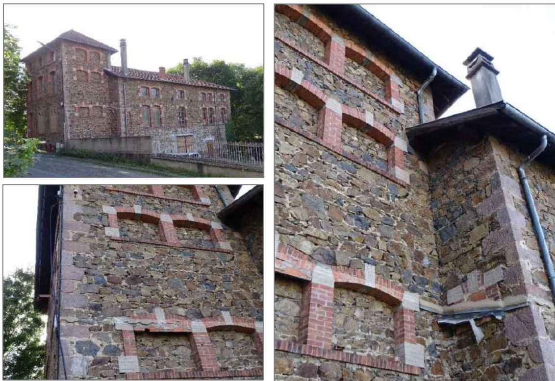
Façade présentant de nombreuses anfractuosités
